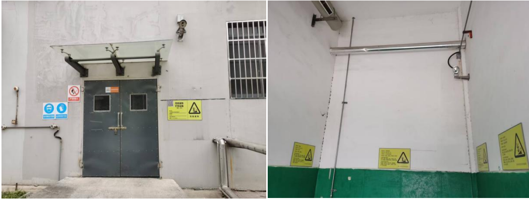
图 3-2 污染物排放口标识牌
